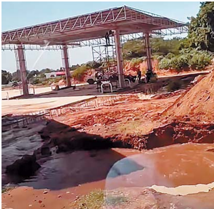
■ Un socavón dejado por el trascabo que dañó la tubería de agua potable y que Ceabien ha sido incapaz de reparar.
