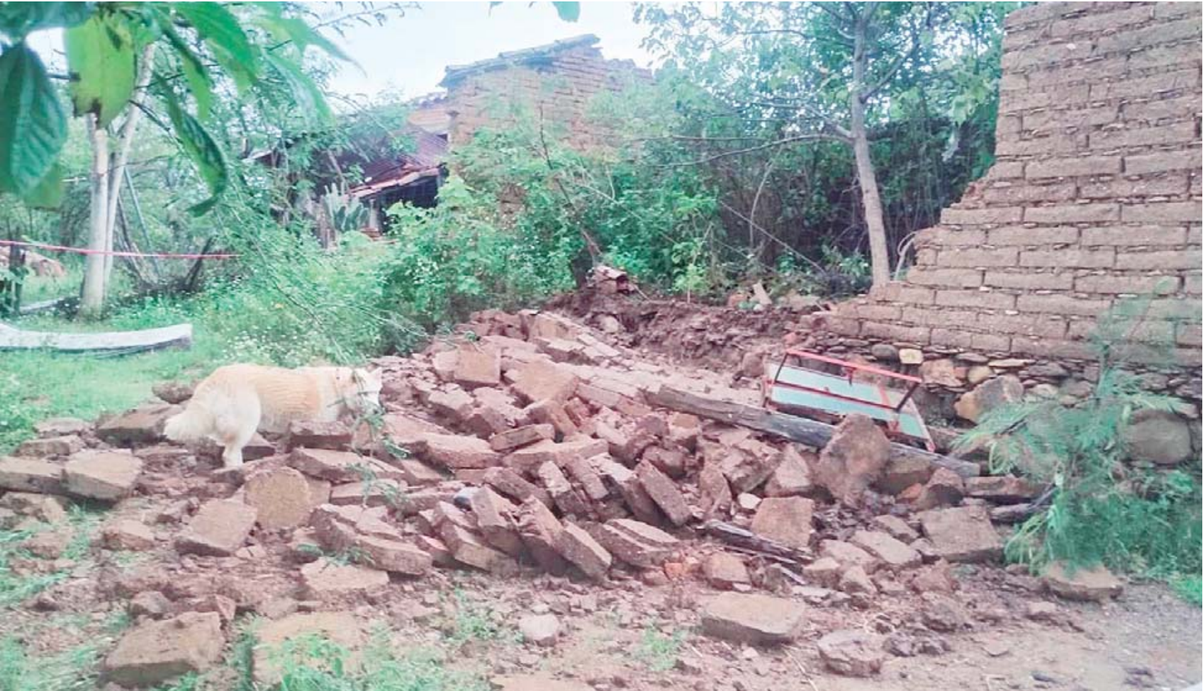
El reblandecimiento de la tierra derivado del temporal lluvioso causó la caída de muros de adobe vulnerables en la Mixteca.
