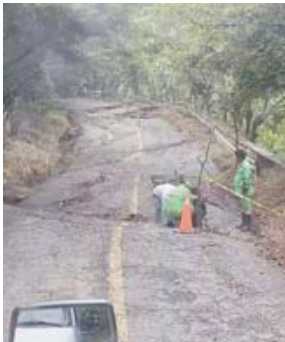
■ Hundimiento en la carretera Jalapa de Díaz a Huautla de Jiménez.
