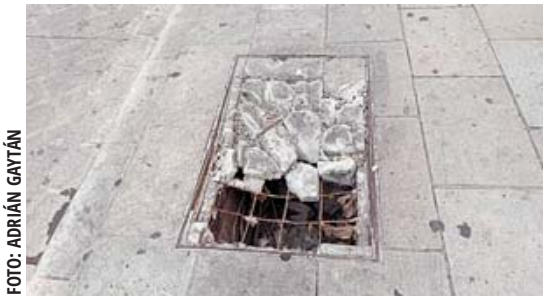
Registro colapsado en Miguel Cabrera entre Aldama y Mina.
