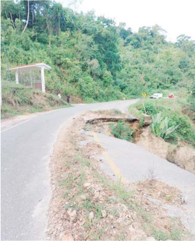
El mal estado de la carretera ha alertado a los ciudadanos.
