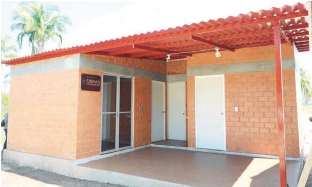
Las endebles viviendas para damnificados por el huracán Erick.
