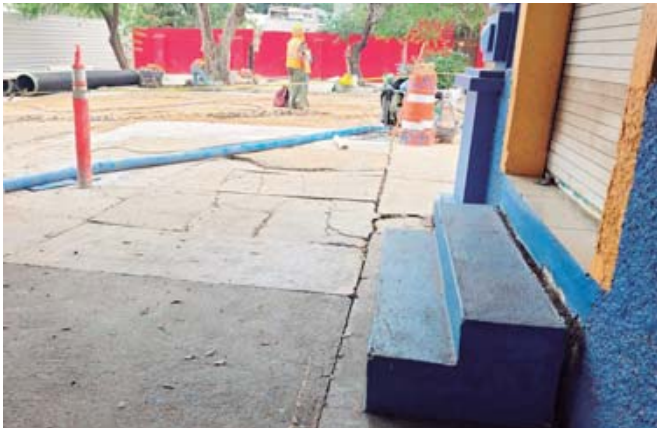
Las notorias fisuras y desprendimientos en inmuebles y en vía pública que autoridades pretenden ignorar.
