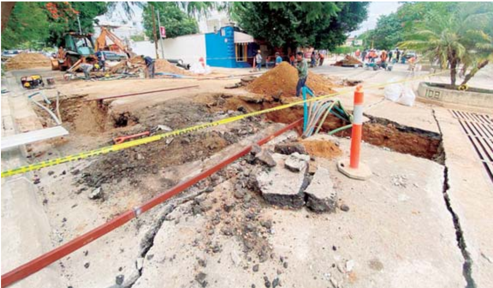
■ El temor de vecinos por los daños y peligro que desaparezca la calle de Eucaliptos, en la colonia Reforma.
