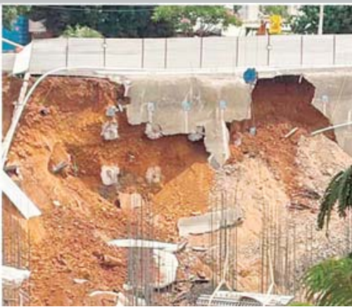
■ Socavón por el desplazamiento de tierras.
