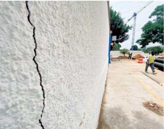
■ Los muros de un inmueble, a 15 metros alejado del socavón de Fibra Danhos pero que ya ha afectado predios particulares.
