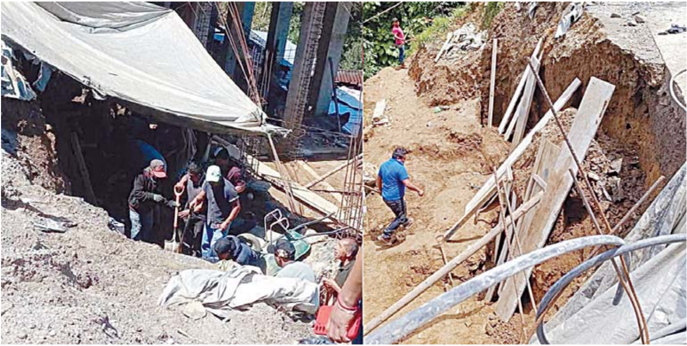
■ Dos trabajadores fueron rescatados con vida tras quedar sepultados por un derrumbe en una obra de Cerro Clarín, Huautla de Jiménez.
