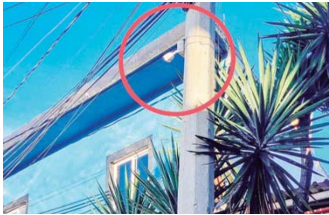
Cámara de vigilancia colocada en postes de electricidad en San Lorenzo Cacaotepec.
