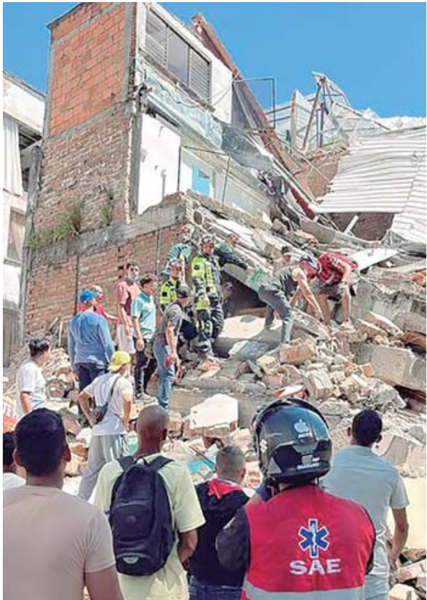
■ Cali reforzó la seguridad y las labores de rescate luego de los daños provocados por el terremoto.
