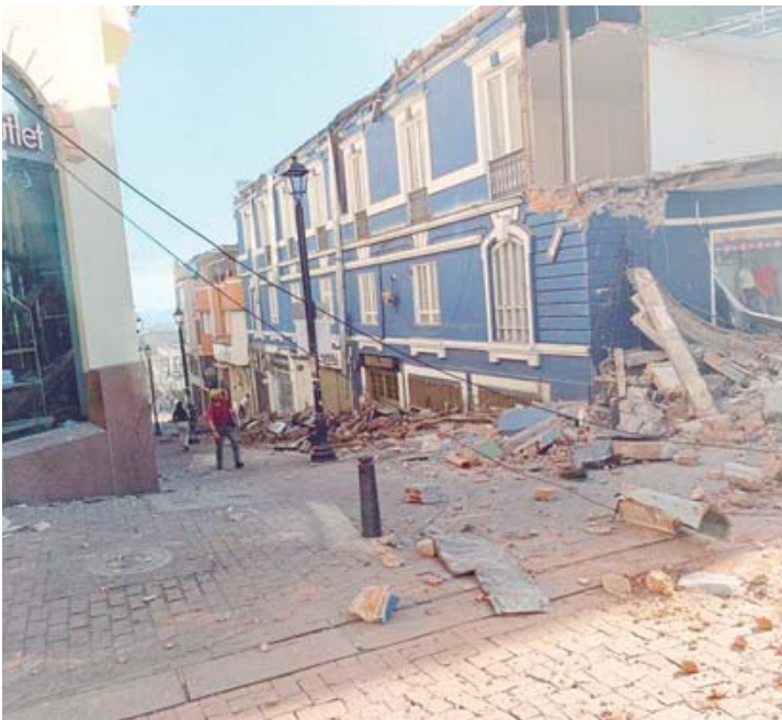
■ Viviendas y edificios resultaron afectados por el movimiento telúrico.
