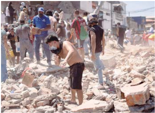
■ Trabajan entre los escombros de edificios colapsados tras el terremoto de 7.4 grados.
