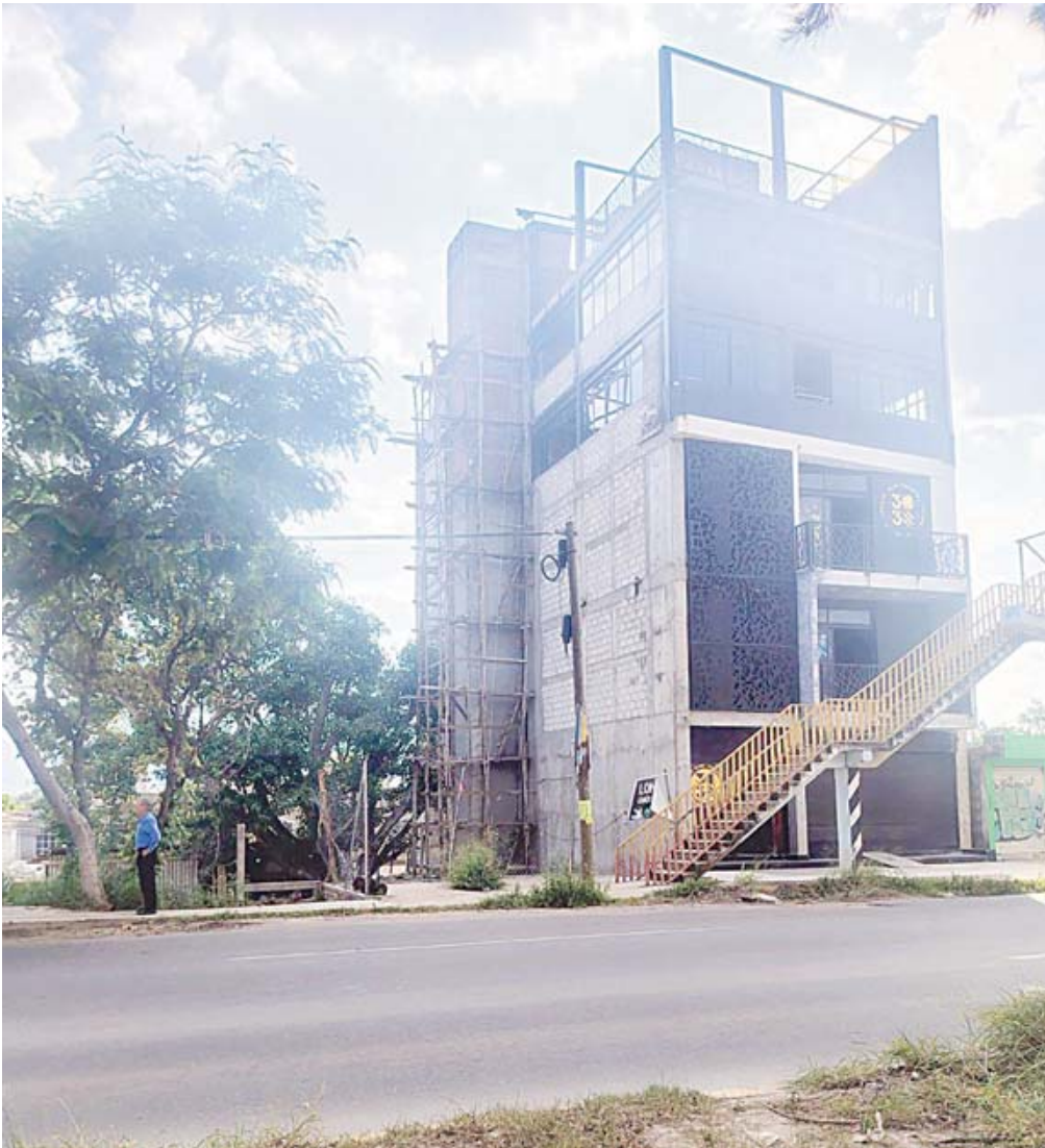
Corporaciones policiales y peritos de la Fiscalía de Oaxaca inspeccionaron el cubo del elevador en el “Edificio Kratos”.
