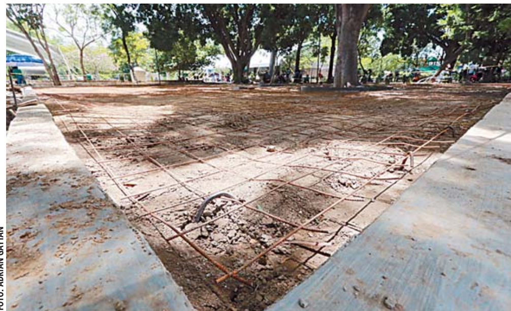
La malla de varilla y alambón para convertir las jardineras en un aplasta de cemento.
