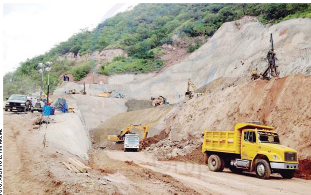
Tradeco, empresa favorita de Calderón, había iniciado las obras en Paso Ancho. Quedaron en el olvido.
