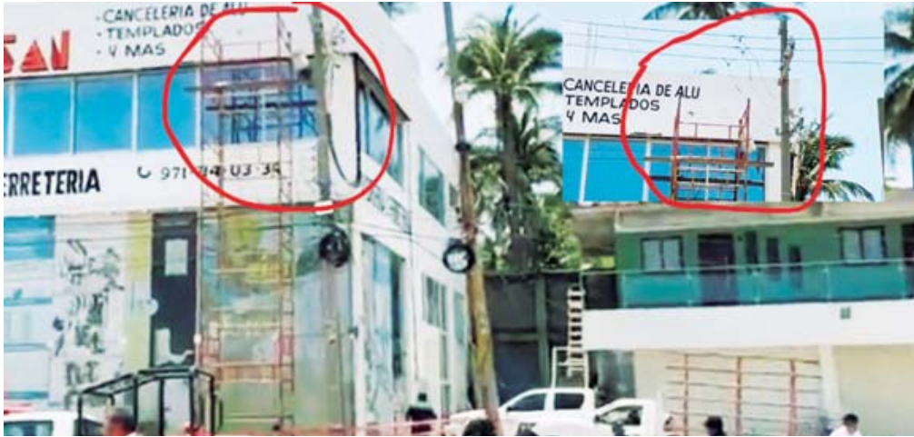
El andamio utilizado durante los trabajos quedó electrificado; se desconoce el estado de salud del joven.
