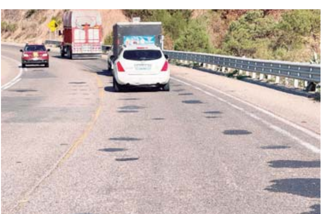
■ Parches por todos lados, baches, pavimento fracturado, peligroso cóctel para automovilistas.
