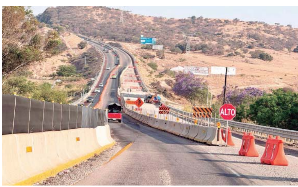
■ Interminables obras por rehabilitar y un derrumbe que no se ha solucionado por más de un mes.
