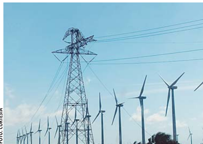
Las fuertes rachas de viento dañan infraestructura de la CFE en el Istmo.
