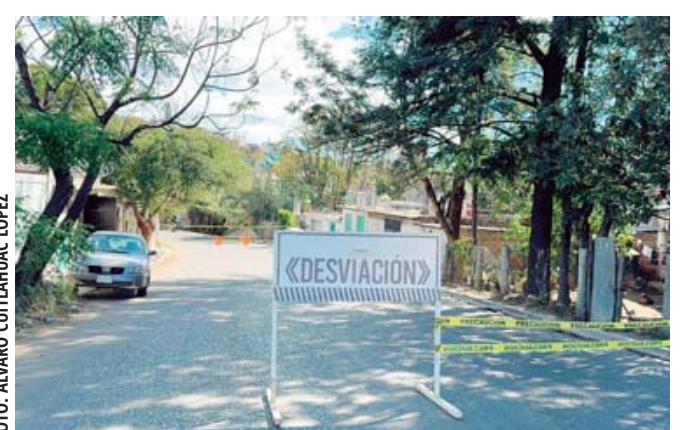
Con señalamientos desvían el tráfico vehicular de la zona de obra de la agencia de Donají, al norte de la ciudad.
