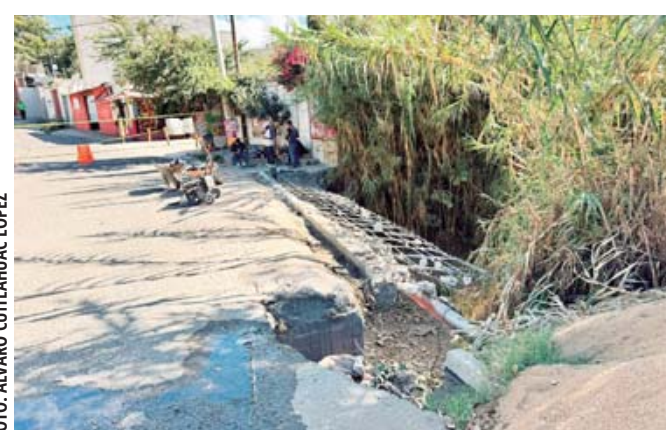
Se observa la malla de lo que será el nuevo puente luego de la demolición del antiguo.
