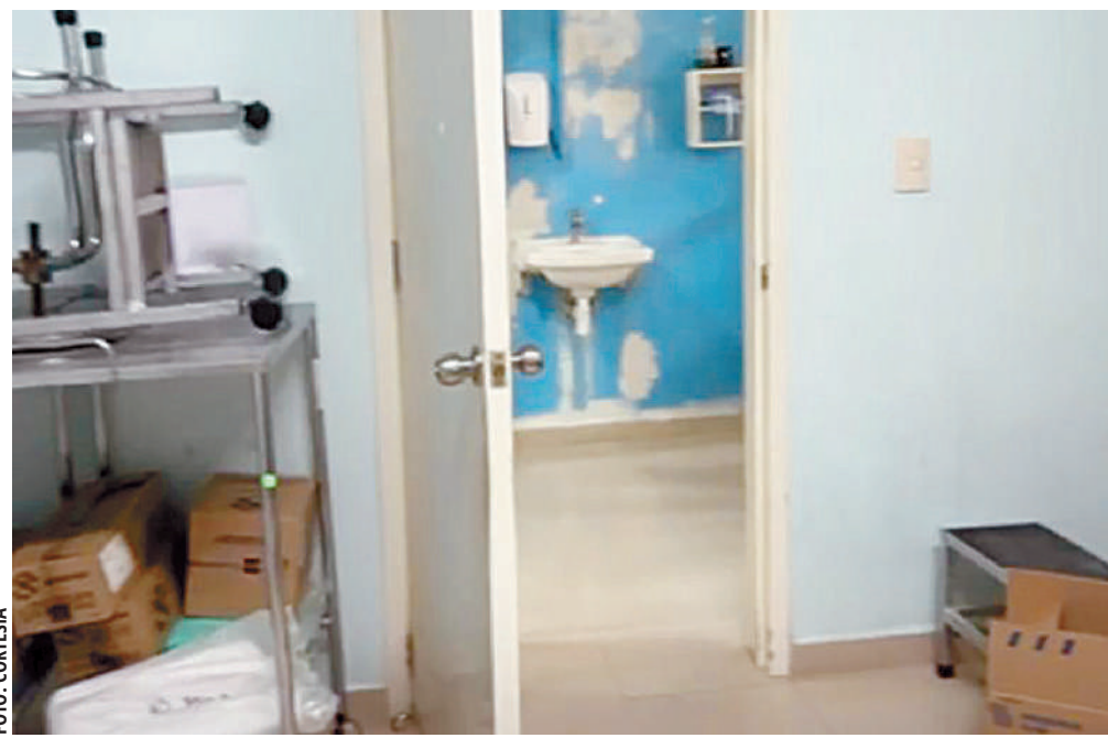
■ Instalaciones sin pintura, sucias, con acumulación de objetos, equipo dañado, así opera el Hospital de la Niñez Oaxaqueña al 30%
