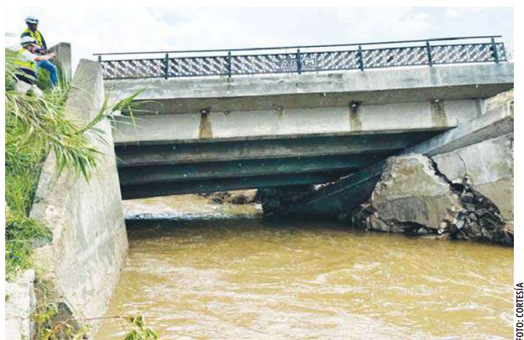
El puente Revolución colapsó en la Villa de Mitla, ante las intensas lluvias.
