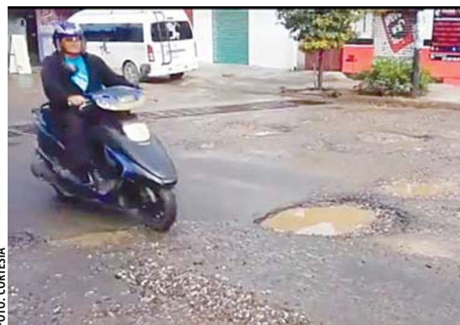
■ Con las lluvias, los baches vuelven a brotar en las calles de Santa Lucía del Camino.
