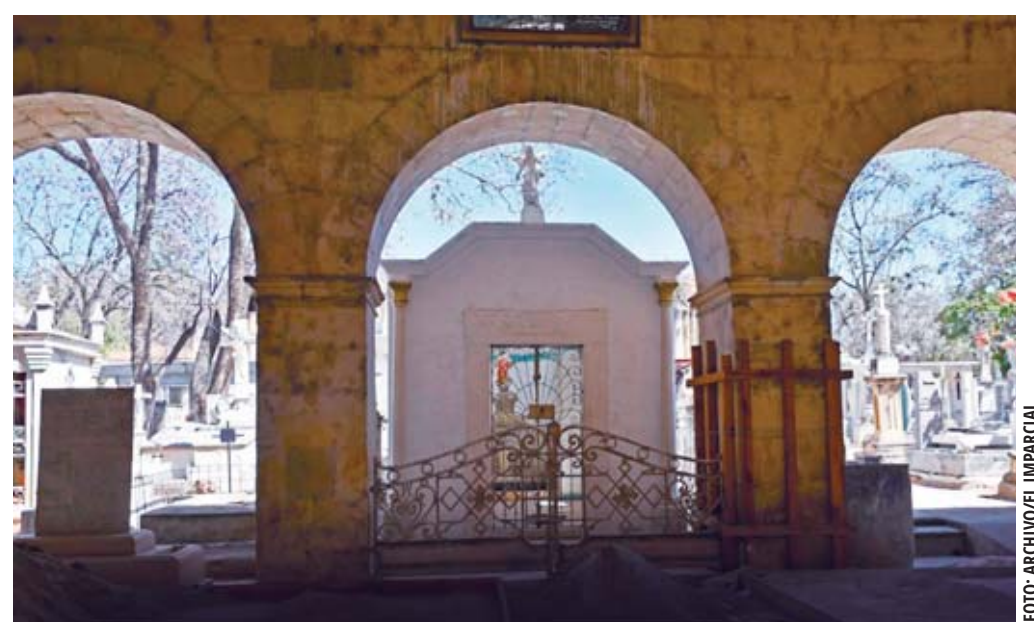
El Panteón San Miguel fue uno de los inmuebles afectados por los sismos del 2017.
