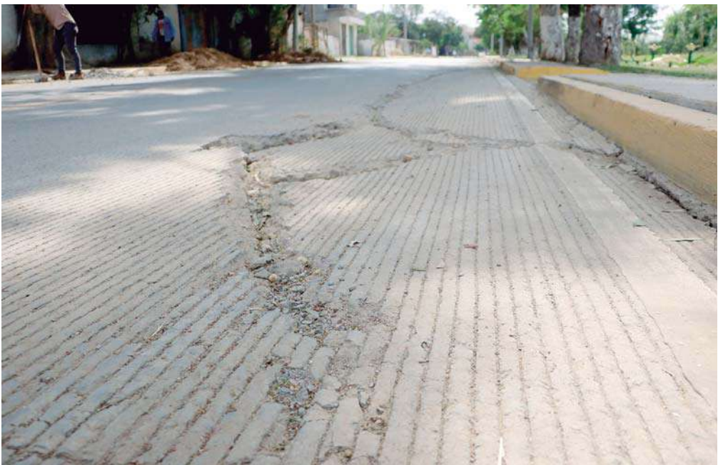
■ Fisuras, cuarteaduras y hundimientos en el Circuito Interior que ayer se inauguró.
