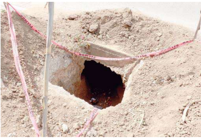
■ Obra inconclusa, con registros abiertos y hundimientos a espaldas de la URSE de la colonia Alemán.
