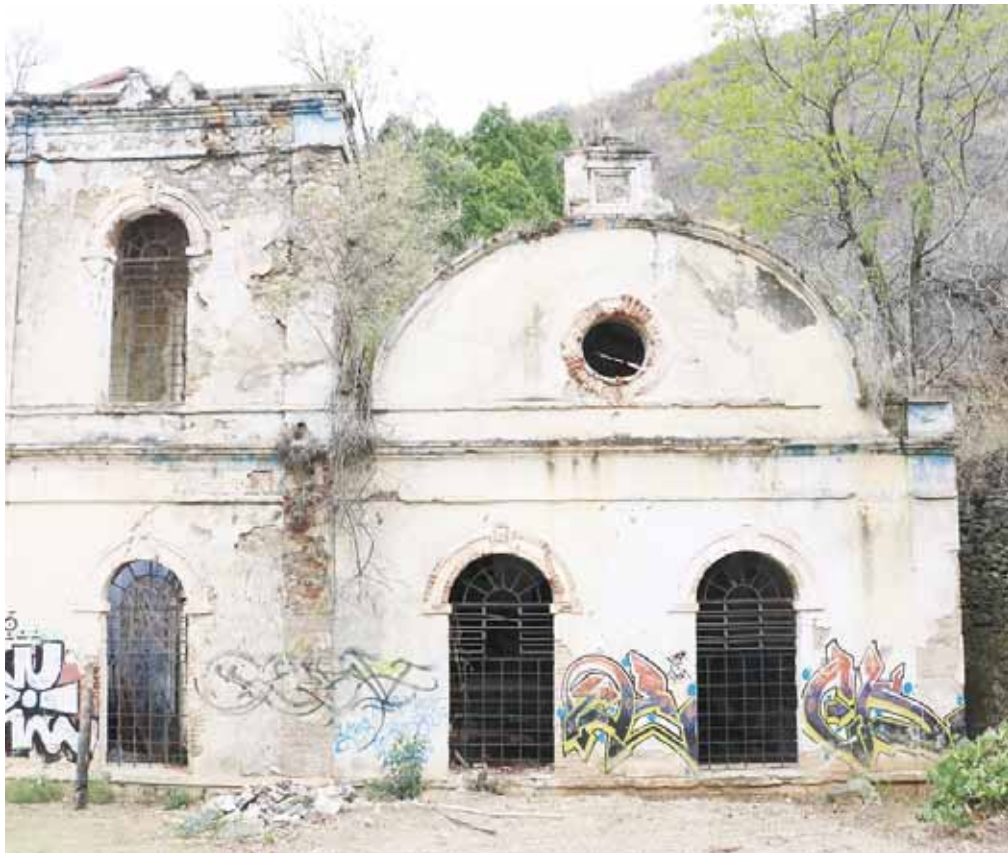
Las ruinas de la planta eléctrica han sido vandalizadas con grafitis en todas partes.
