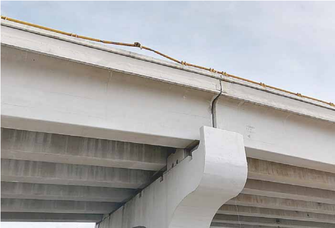
■ El Puente de Cinco Señores tiene algunas fracturas y daños en su estructura.
