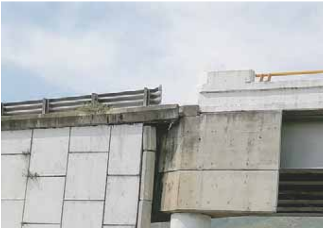
■ En Tlaxiáac, el puente presenta algunas grietas.
