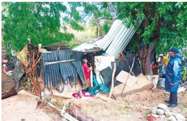
► Humildes viviendas se quedaron sin techo.
