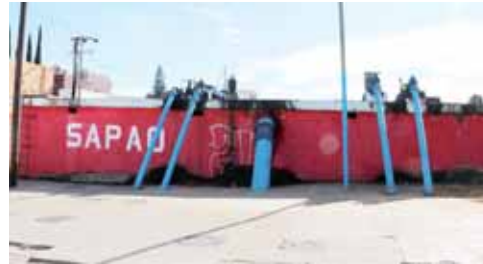
► En la colonia Volcanes están los estanques de rebombeo de SAPAO.
