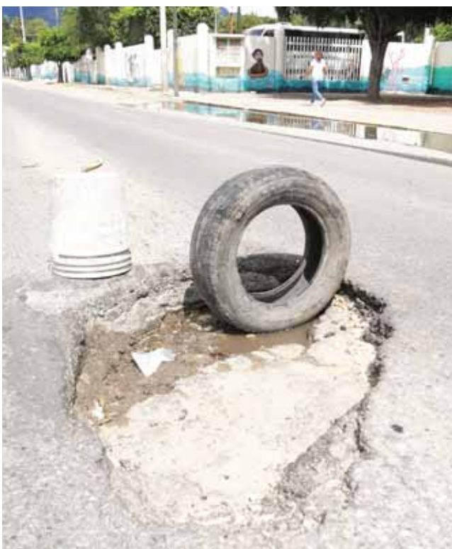
► Bache en Avenida Universidad, con 40 centímetros de profundidad, aproximadamente.
