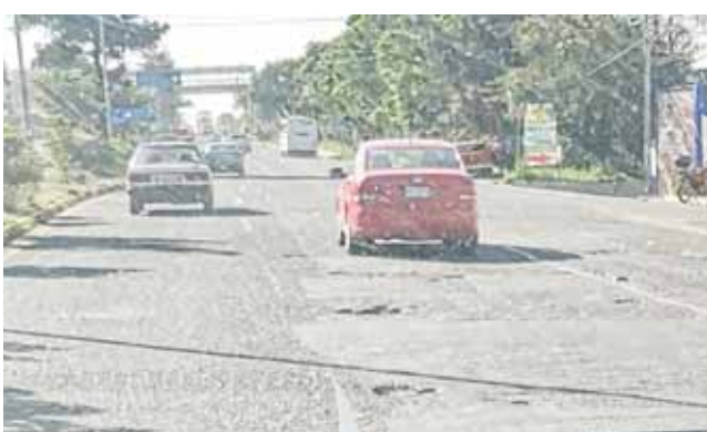
► La carretera federal 190, a la altura de Viguera, está llena de baches.
