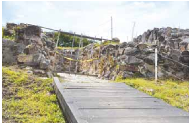
▶ Las rutas que presentan daños han sido cerradas por seguridad.
