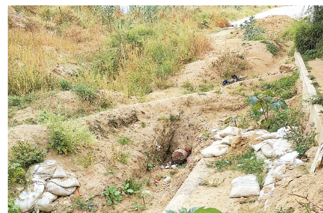
► Hay varias obras de SAPAO abandonadas en zonas conurbadas.
