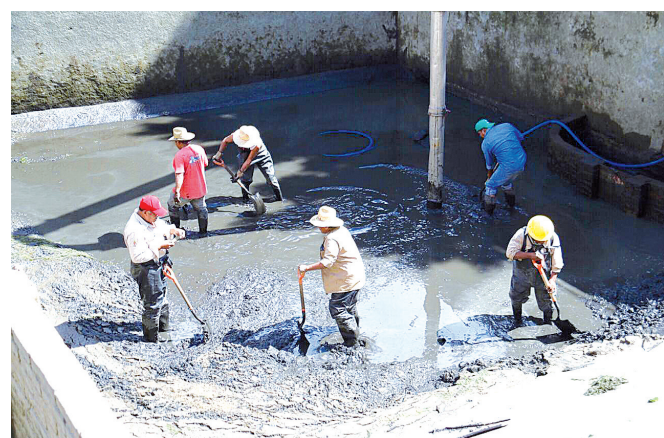
► La planta tratadora de aguas negras opera a un 40% de su capacidad.
