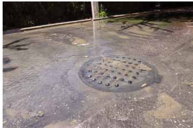
► Brota el agua negra de las coladeras.
