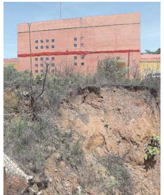
El hospital de San Agustín Loxicha es un sueño que aún no se concreta. La obra, que presenta un avance de más de 70 por ciento, sigue abandonada.
