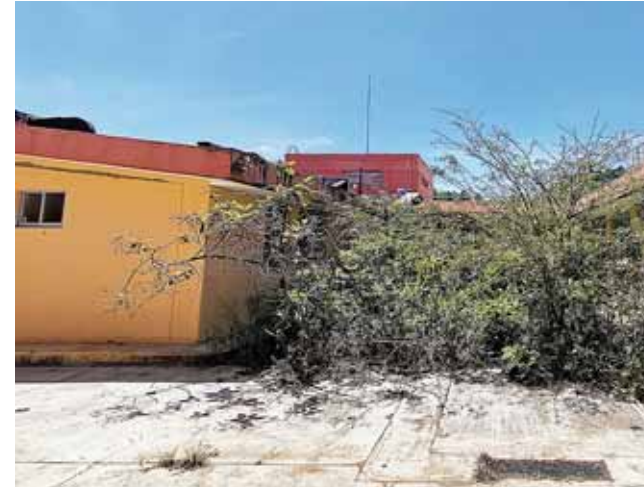
► En medio del patio del hospital se observa como ha crecido la maleza.
