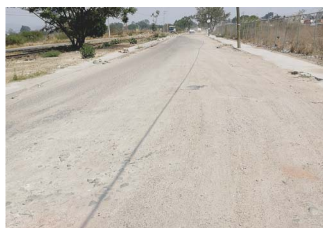
► El Circuito Interior se encuentra en pésimas condiciones.
