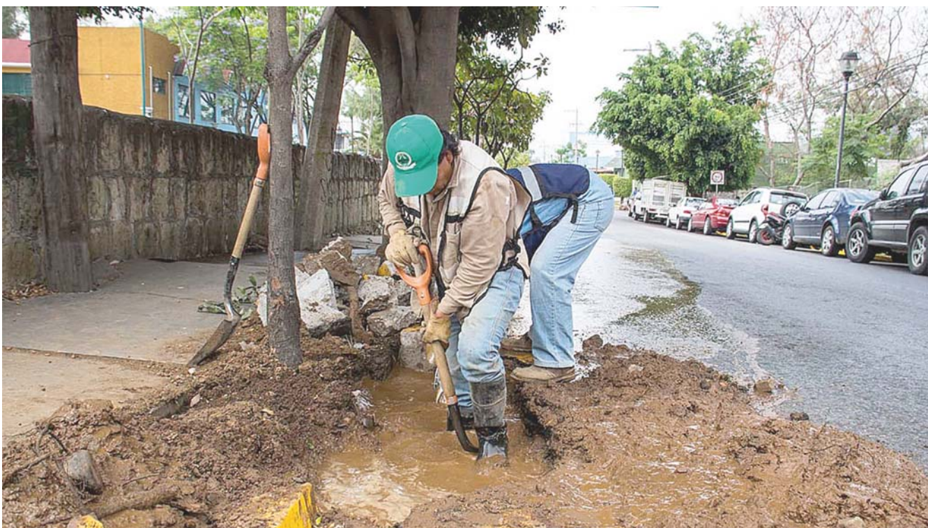
► Trabajadores atienden una fuga de agua.
